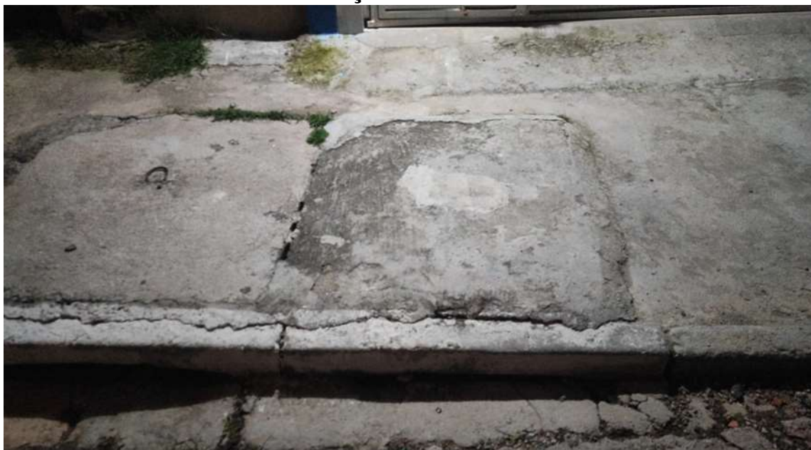
Tampa do bueiro danificada.
